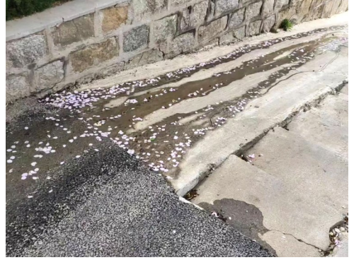
莱山区迟家小区路面上的污水
