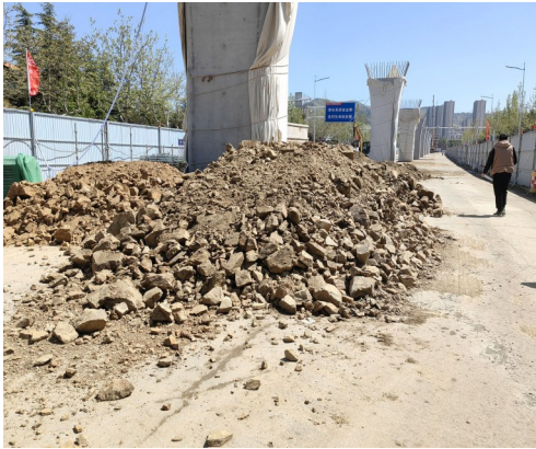
芝罘区红旗西路工地未覆盖的裸土
