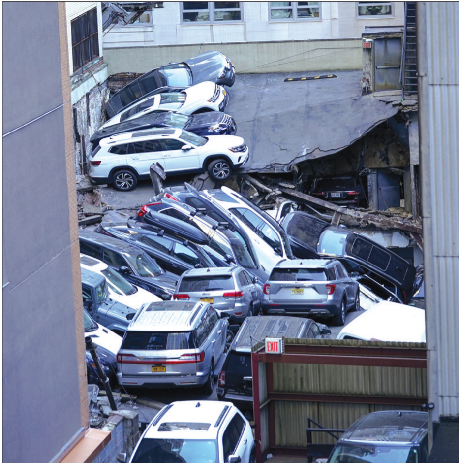
发生坍塌事故的停车楼。
