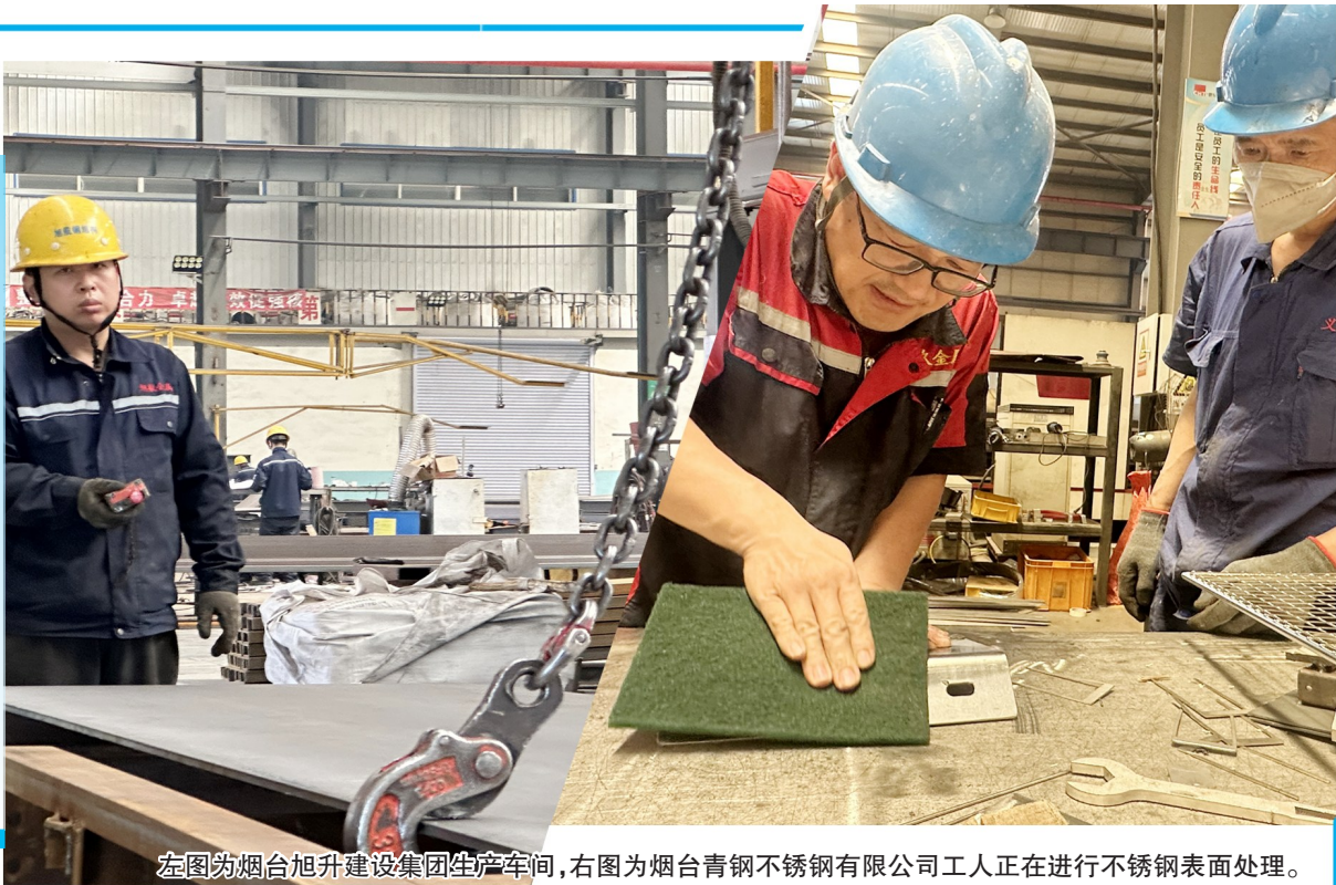
左图为烟台旭升建设集团生产车间,右图为烟台青钢不锈钢有限公司工人正在进行不锈钢表面处理。
