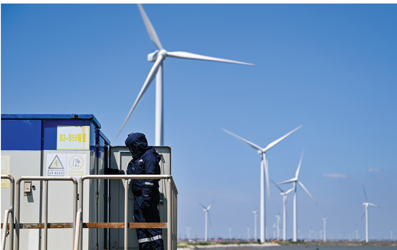
6月25日,在国家能源集团天津龙源新能源有限公司马棚口风电场,检修人员在风机旁检查箱式变压器。随着夏日用电高峰来临,近日国家能源集团天津龙源新能源有限公司组织检修人员对所辖4座风电场的风机开展定期检修维护工作,保障夏季新能源电力可靠供应。
