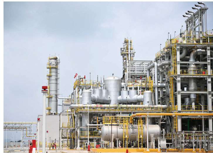
这是3月26日拍摄的巴斯夫(广东)一体化基地乙烷联合装置。当日，巴斯夫(广东)一体化基地项目在广东省湛江市全面投产。这一项目总投资约87亿欧元，是德国企业在华投资规模最大的独资单体项目。 新华社
