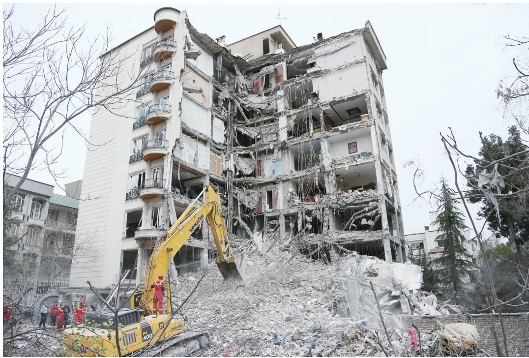
3月23日在伊朗德黑兰一处居民区拍摄的被毁建筑，该居民区曾在美以军事行动中遭受袭击。新华社
