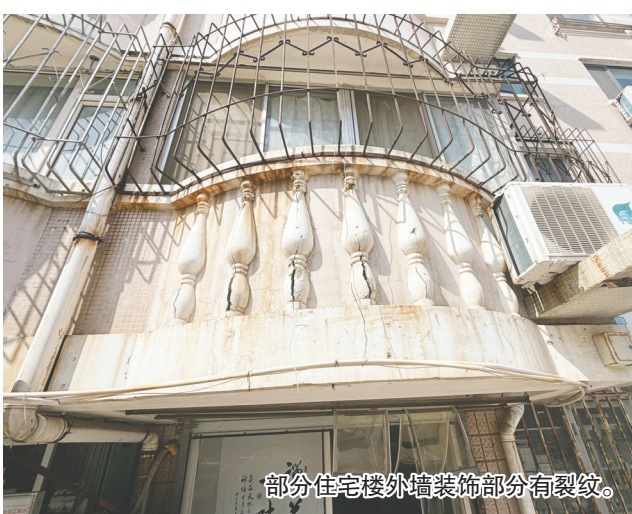
部分住宅楼外墙装饰部分有裂纹。
