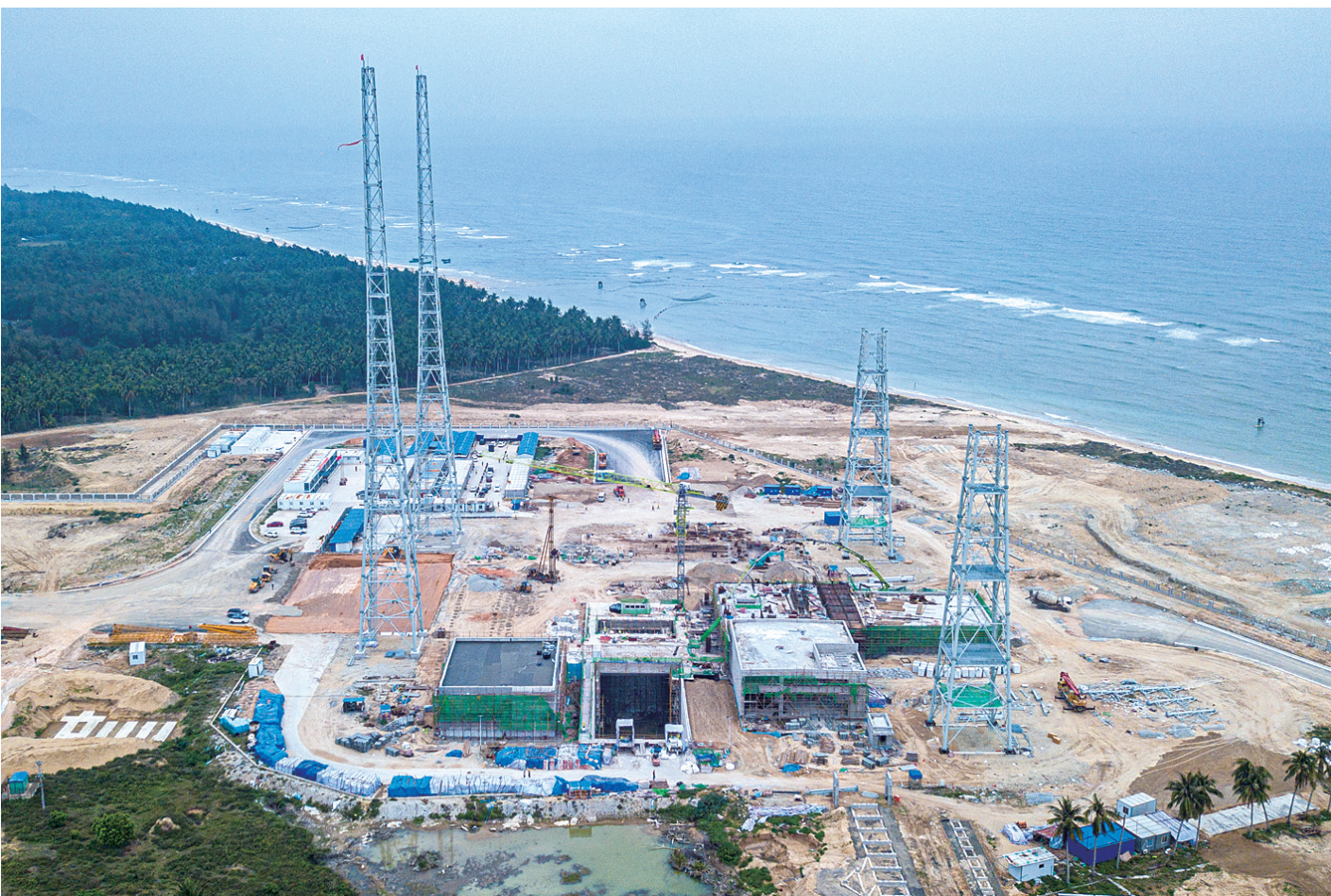
建设中的海南国际商业航天发射场二号发射工位(无人机照片,3月6日摄)。 春日琼岛，生机盎然。在推进自贸港封关运作的攻坚之年，海南省多个重大项目建设稳步推进。 新华社
