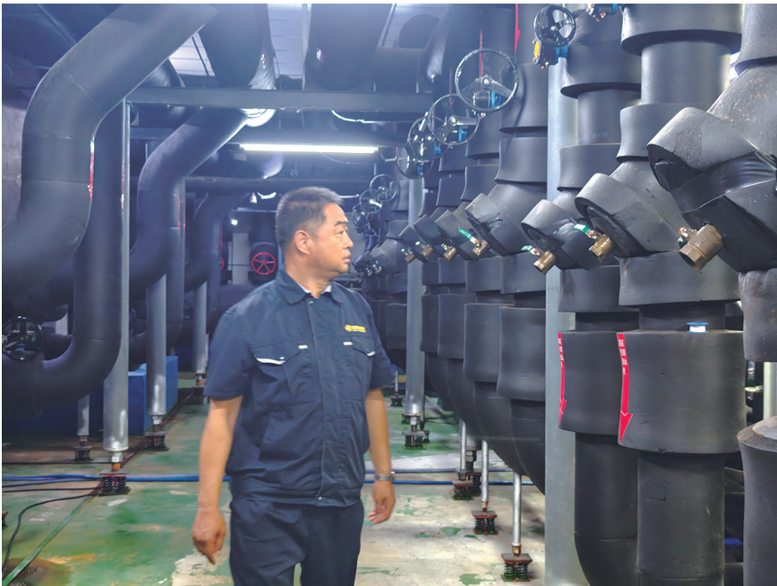
丰金集团供暖管理中心经理贺建敏巡查地源热泵机房。
