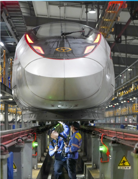
↑在中国铁路哈尔滨局集团有限公司哈尔滨动车段检修库,电务段信号工人对动车组ATP列车超速自动防护系统进行检测作业(1月31日摄)。新华社
